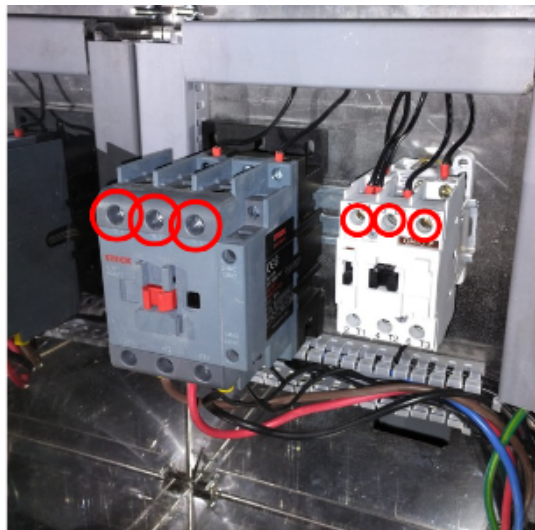
Contactores dentro del tablero.
